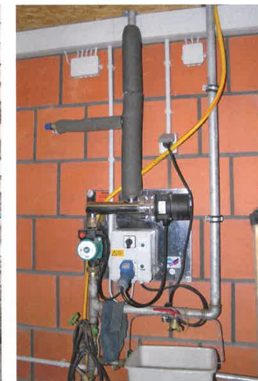
Zirkulationsanlagen pumpen warmes Wasser zu den Selbsttränken.
