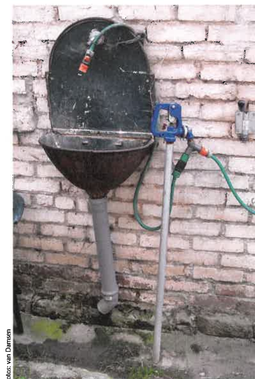
Gute Dienste im Außenbereich leistet ein frostsicherer Wasserhahn.
